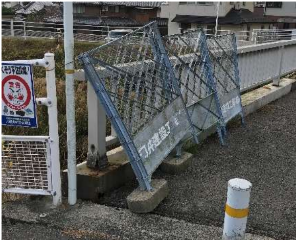
老朽化した車田橋
